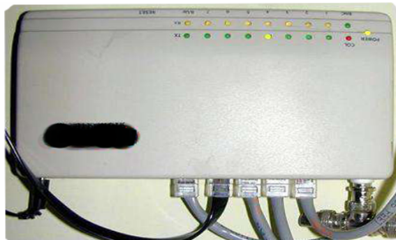
Gambar 6.11 Hub yang sudah di pasangi konektor RJ45
